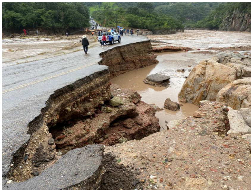
IMAGEN 2. COLAPSO DE PUENTE HIGUITO, TALGUA, LEMPIRA
