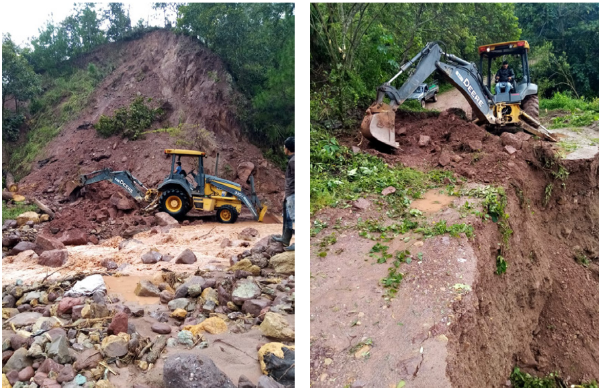
IMAGEN 8. DERRUMBE Y DESLIZAMIENTO SOBRE CARRETERA EN SAN AGUSTÍN, COPÁN
