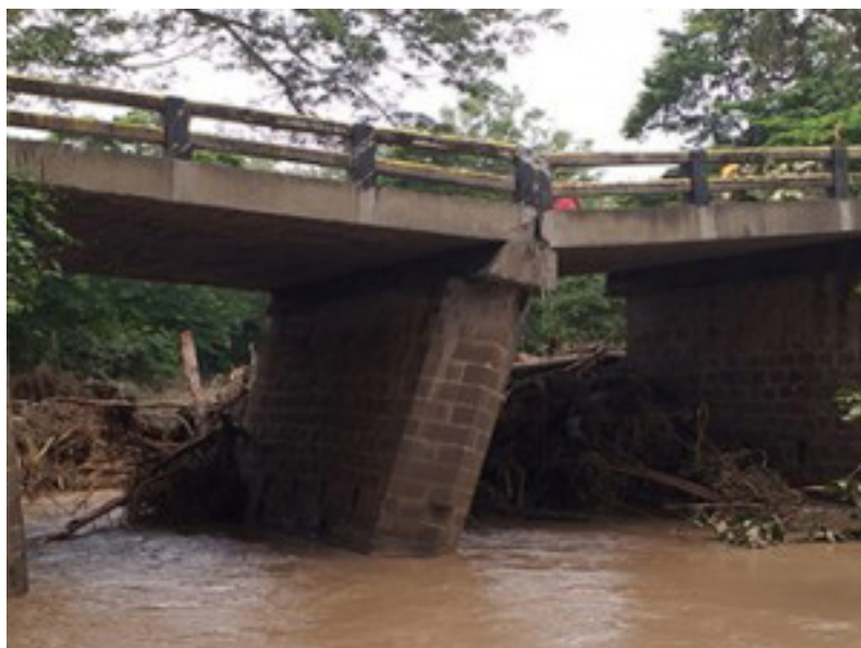
IMAGEN 7. COLAPSO DE PUENTE SOBRE RÍO AMAPA, CORTÉS
